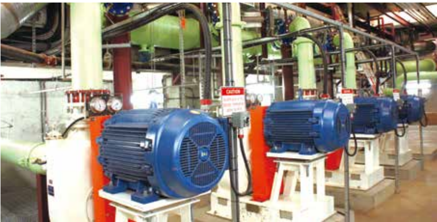
社区能源转换站
